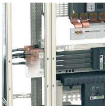
Raccordement reporté dans un compartiment gaine à câbles
