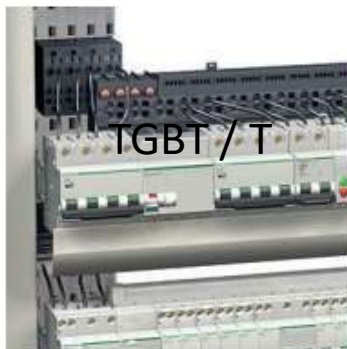
Un appareil "tête de groupe" alimenté un répartiteur Linergy FM 80 A
