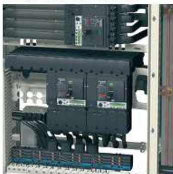
2 ComPact NSX250 verticaux alimentés par un répartiteur Linergy FC
